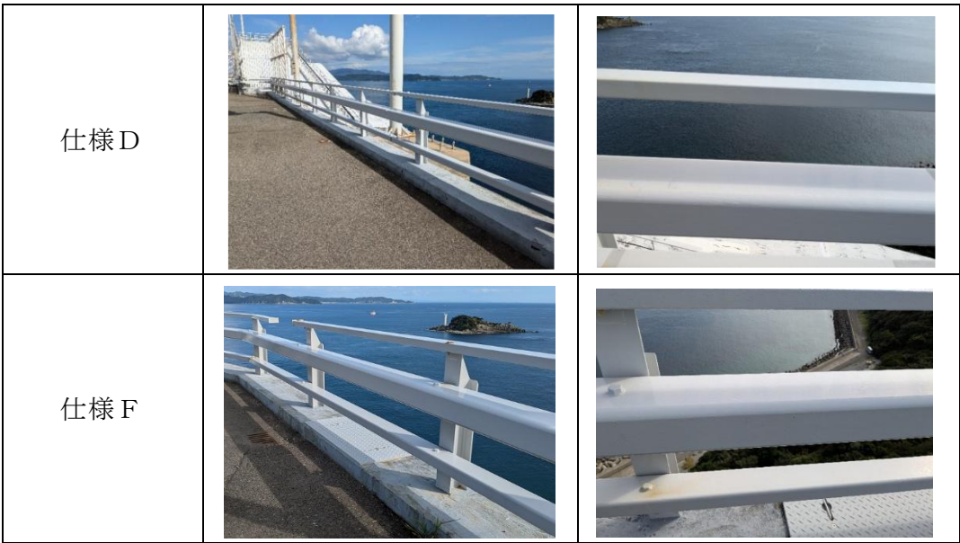
図 9 大鳴門橋 5A アンカレイジ上自動車防護柵試験塗装 7 年経過
