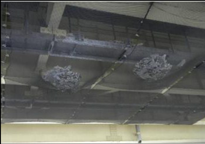
床版コンクリートのはく落
